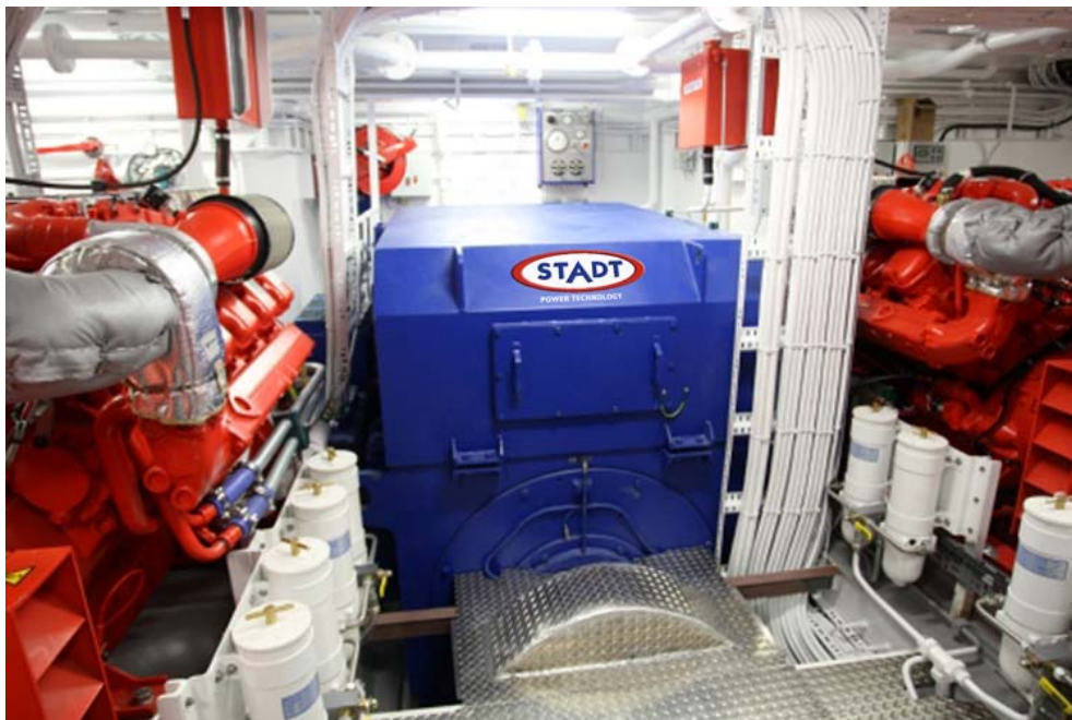
BILDE 2: Typisk installasjon med STADT elektrisk framdrift. Elektromotoren her i midten, generatorar på sida.
